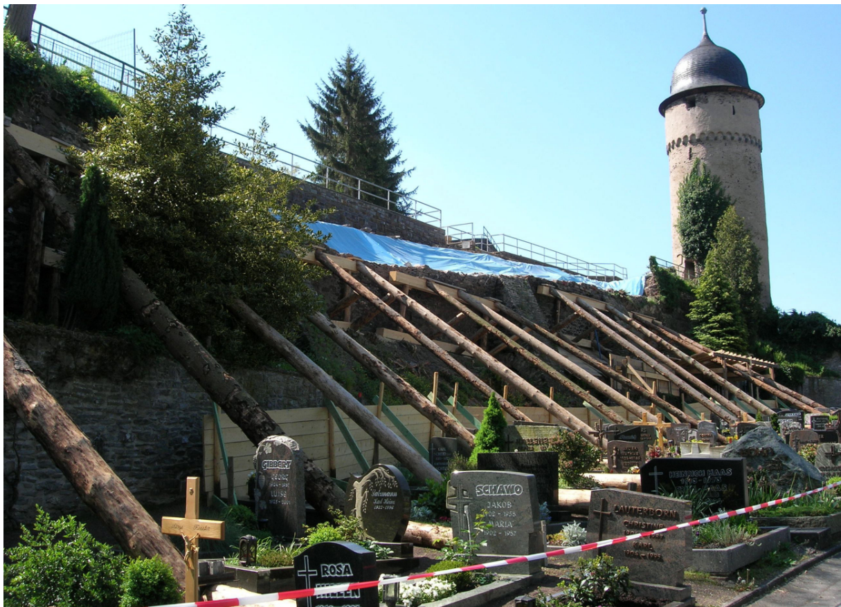
Abb. 2: Provisorische Abstützung einer durch Rutschmassen einsturzgefährdeten Mauer
